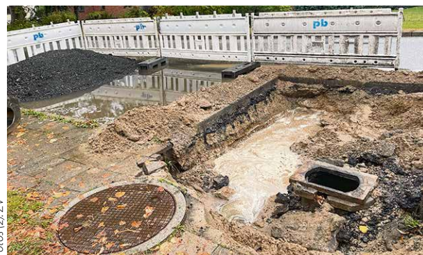
▼ Beim nächsten Guss stand die Baugrube unter Wasser.
