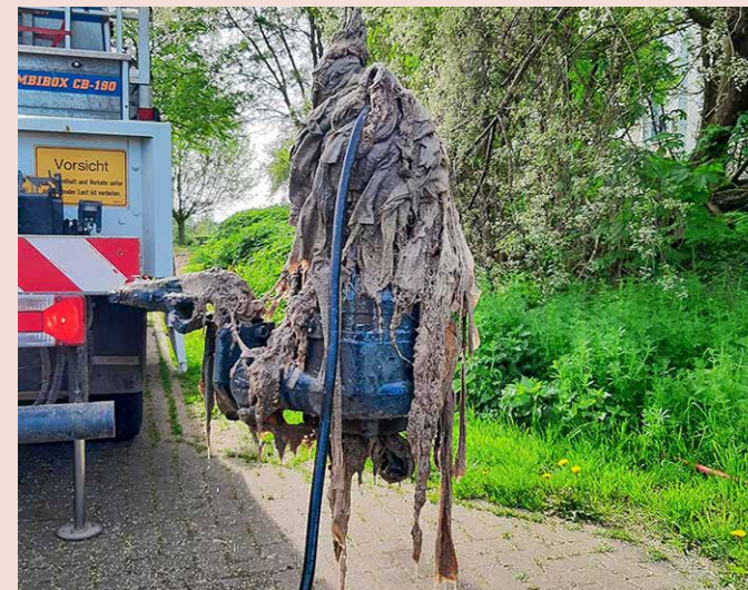
Unappetitlich und unnötig. Unsachgemäß entsorgte Feuchttücher legen Pumpen lahm. Das erhöht den Wartungs- und Pflegeaufwand. Foto: ZVG
