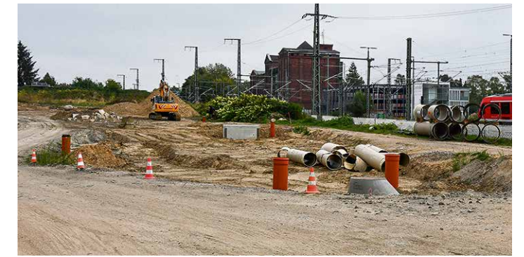
Auf dem knapp 9.500 Quadratmeter großen Gelände neben der Bahnstrecke wird ein Regenrückhaltebecken gebaut. Fotos: SPREE-PR/Fuchs
