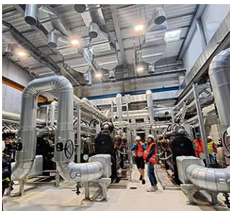
Mitarbeitende des Zweckverbandes besichtigen die Geothermie-Anlage der Stadtwerke Schwerin. Foto: ZV Wis
