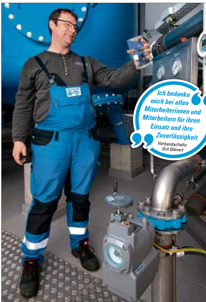
Tobias Ehrt sichert die Wasserversorgung im Werk Gamehl, ohne Kontakt mit dem Nass zu haben. Das Trinkwasser wird in einem geschlossenen System aufbereitet.
