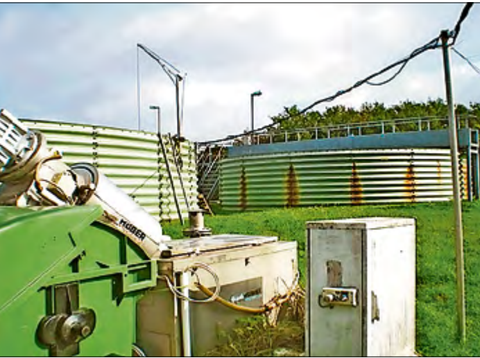
Schon von Weitem gut zu erkennen: Die Bausubstanz der Kläranlage Hornstorf hat ihre besten Jahre lange hinter sich. Foto: ZV Wismar
