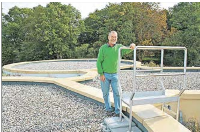
Hoch oben auf insgesamt 600 m 3 Reinwasser: Horst Bremer kennt alle Anlagen im Verbandsgebiet und jedes Detail im neuen Wasserwerk.
